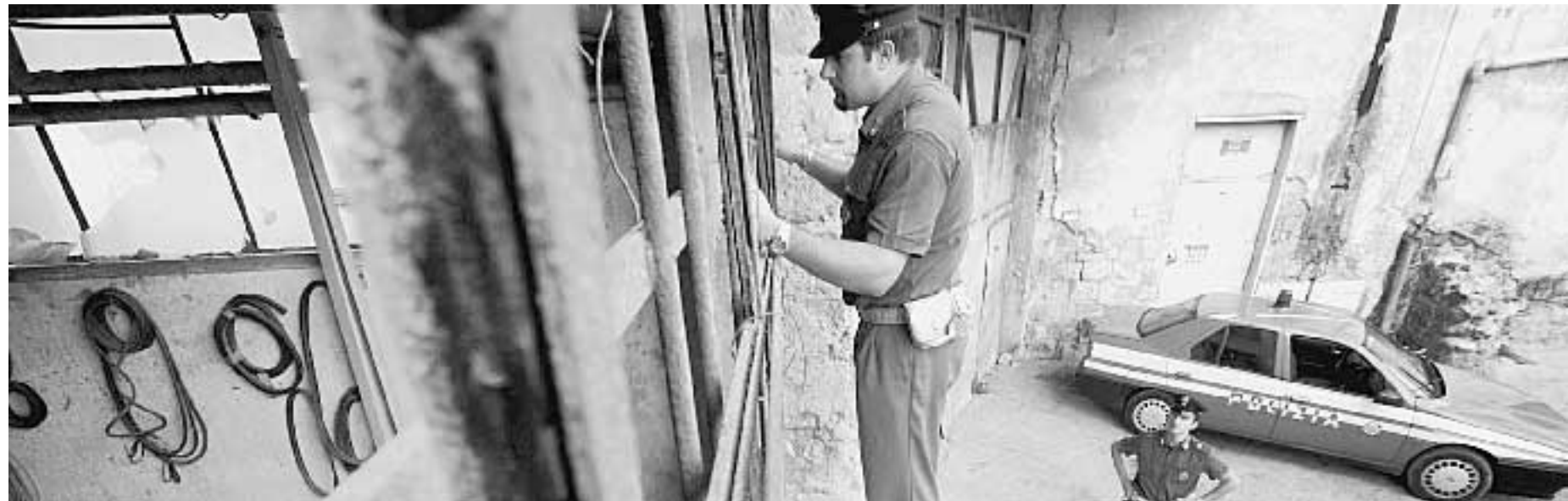
Due agenti di polizia davanti al cantiere posto sotto sequestro dove lavorava l'operaio trovato morto martedì sul ciglio di una strada ad Ercolano
