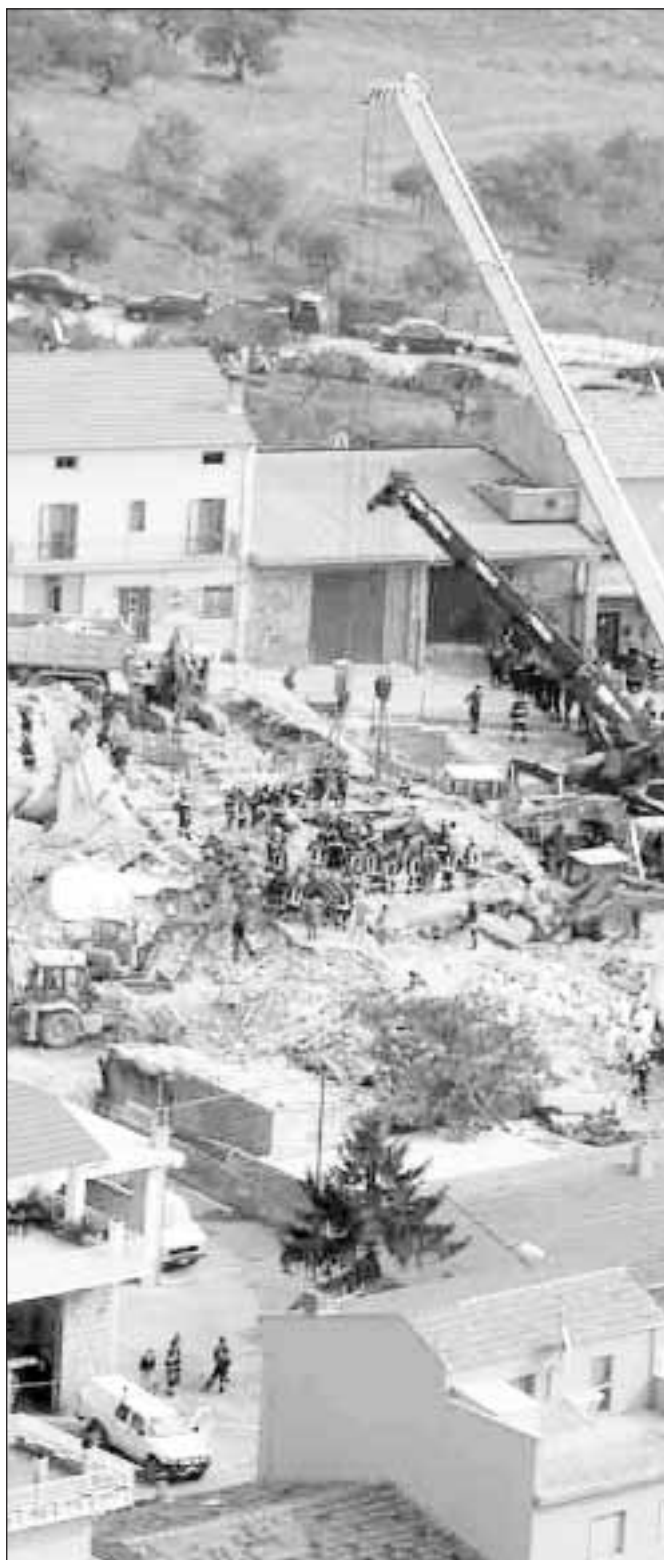
La scuola di San Giuliano dopo il crollo Foto di Ciro Fusco/Ansa
