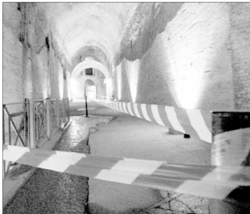
Un corridoio della Domus Aurea trasennato per la minaccia di crolli: per restauri e manutenzione non ci sono più soldi
