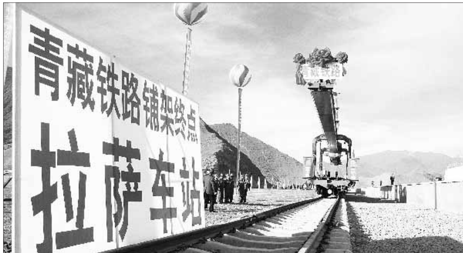
Il cantiere della linea ferroviaria che unirà il Tibet alla Cina. Foto di China Newsphoto/Reuters
