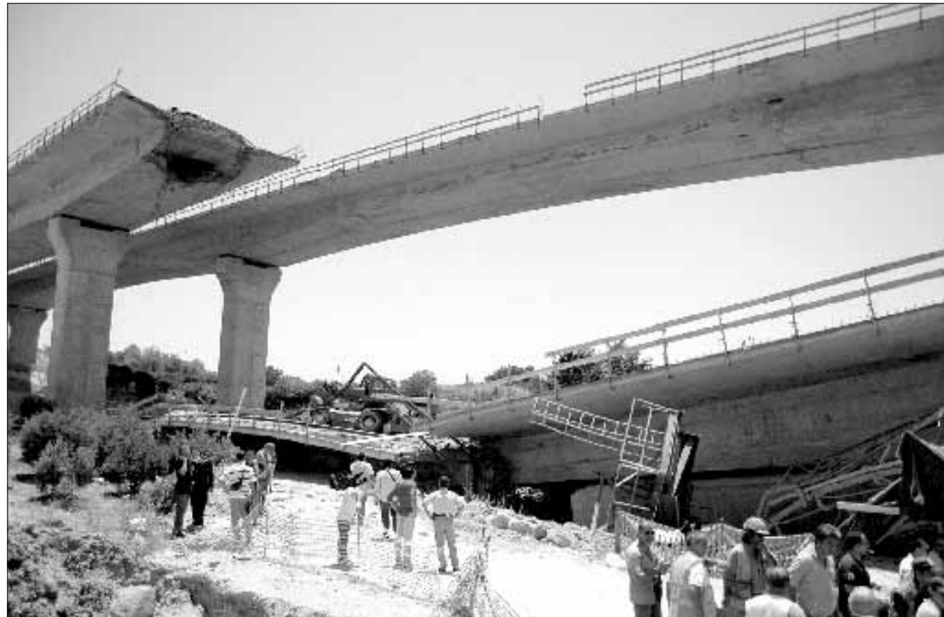
Una panoramica dell'autostrada Catania-Siracusa dove è avvenuto il crollo del ponteggio Foto di Orietta Scardino/Ansa
