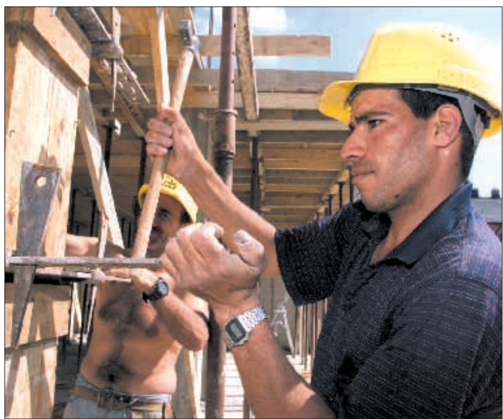
Un operaio al lavoro in un cantiere nel centro di Milano Foto di Dal Zennaro/Ansa
