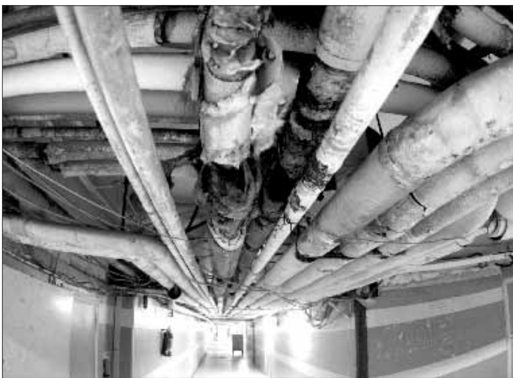
Incrostazioni e ruggine hanno intaccato gli impianti in un reparto del Policlinico Umberto I a Roma. Foto di Claudio Peri / Ansa
