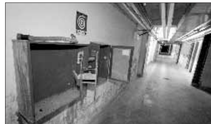
I sotterranei dell'ospedale Montaldi, a Napoli, con le teche dove erano le bombole antincendio rubate per l'ennesima volta. Foto Ciro Fusco/Ansa
