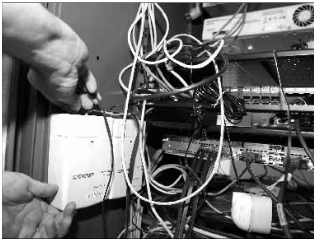
Un operatore al lavoro in una centrale telefonica Foto di Daniel Dal Zennaro
