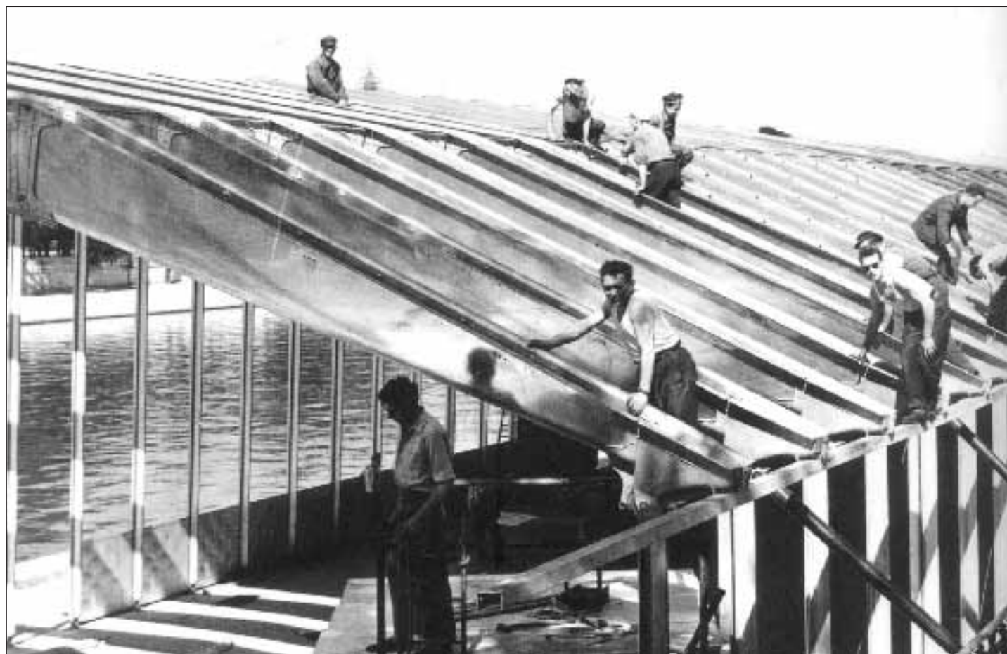
Il Padiglione per il Centenario dell'Alluminio a Parigi, durante la costruzione nel 1954
