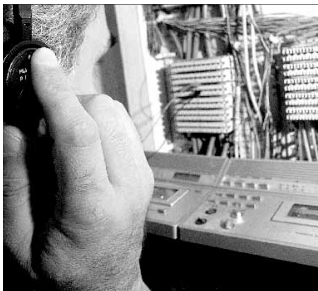
Un operatore al lavoro in una centrale telefonica. Foto di Fusco/Ansa
