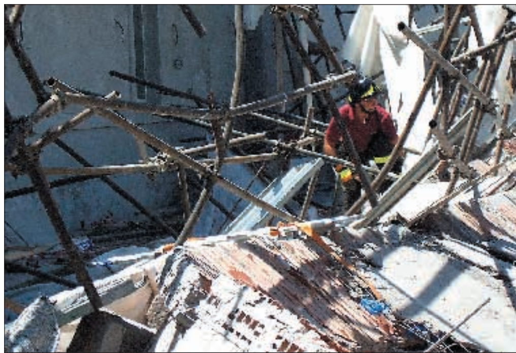
Un vigile del Fuoco mentre lavora tra i resti dell'impalcatura crollata ieri. Foto Ansa
