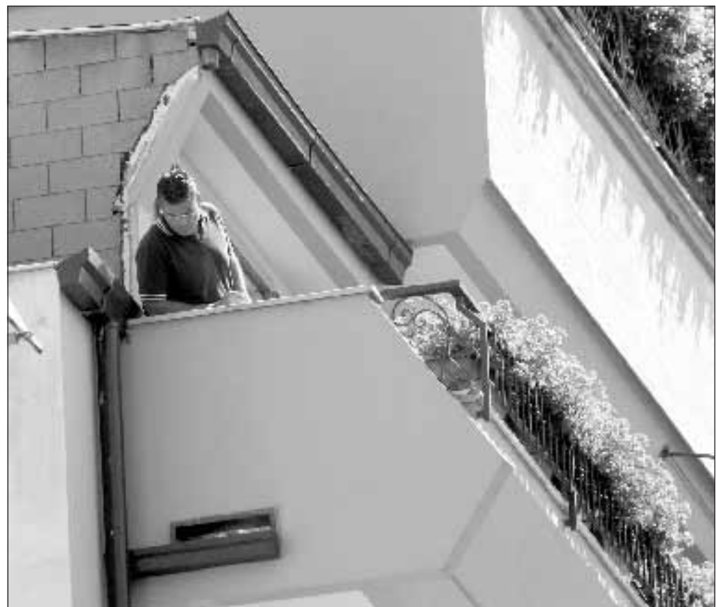
Il palazzo da dove è precipitato Raffaele l'operaio 17enne, mentre montava un condizionatore d'aria. Foto di Cesare Abbate/Ansa
