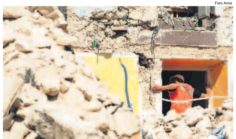
Soccorritori tra le macerie degli edifici di San Gregorio (L'Aquila)
