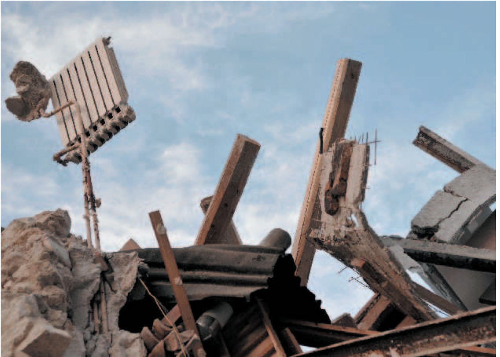
Un termosifone svetta tra le macerie di una casa a Onna
