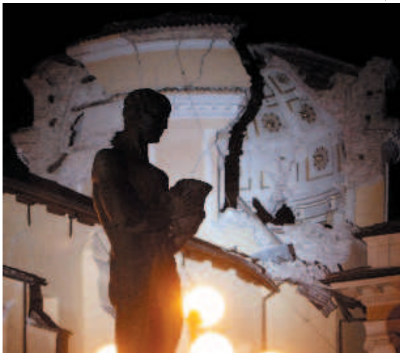
La cupola devastata della Chiesa delle Anime Sante subito dopo il terremoto del 6 aprile
