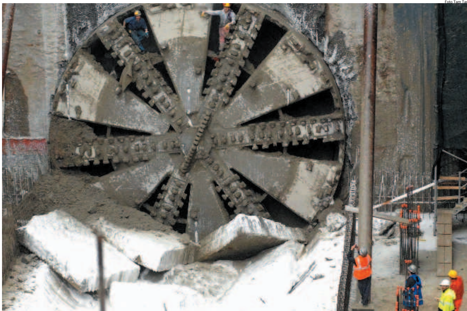
Milano La «Talpa Meccanica» nel Cantiere della Metropolitana 5, una delle grandi opere in via di realizzazione
