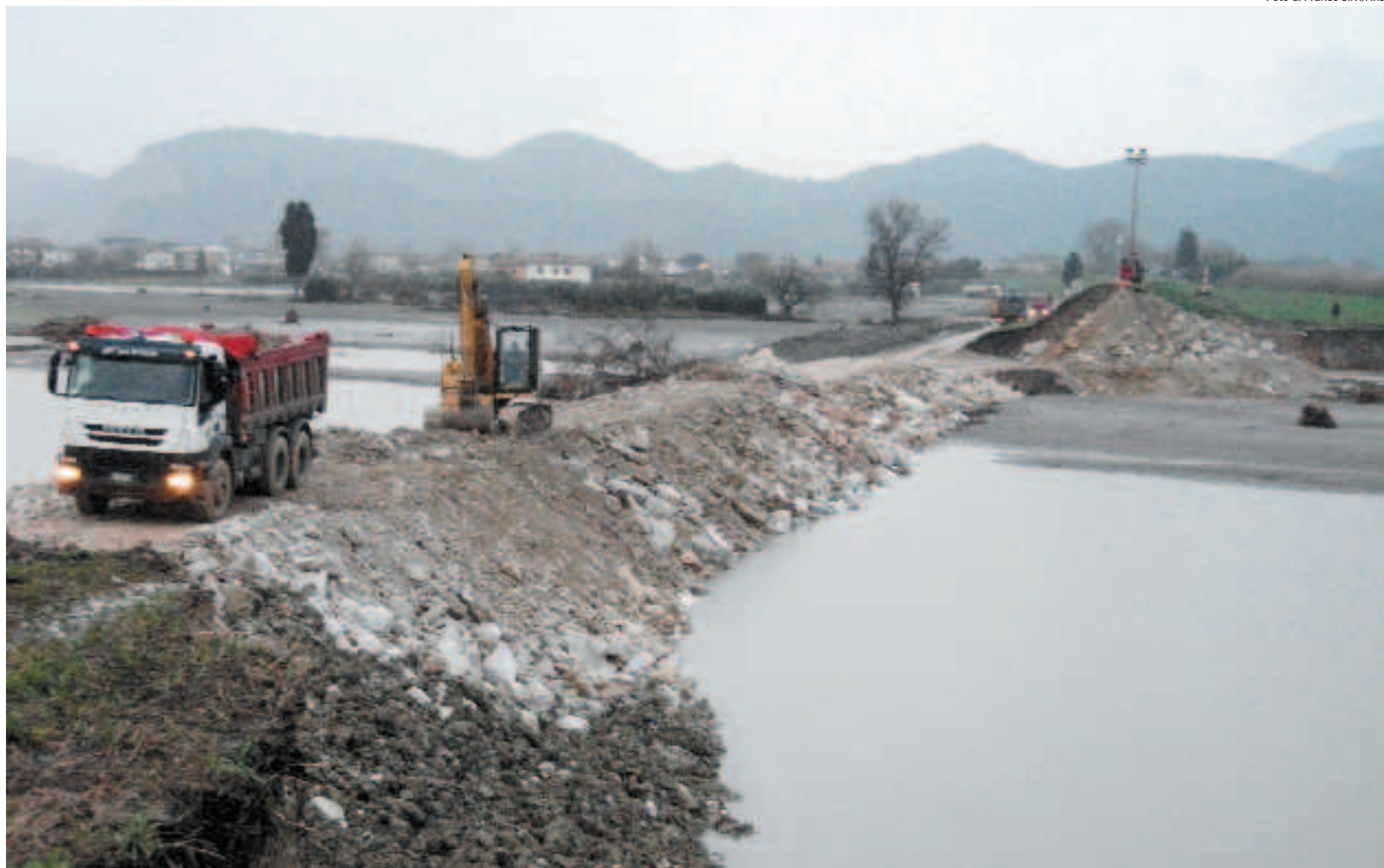
Gli allagamenti nella zona dell'argine costruito in tempi record a Nodica (Pisa)
