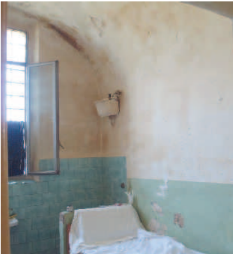
Macchie di umido alle pareti dell'Ospedale di Montelupo Fiorentino
