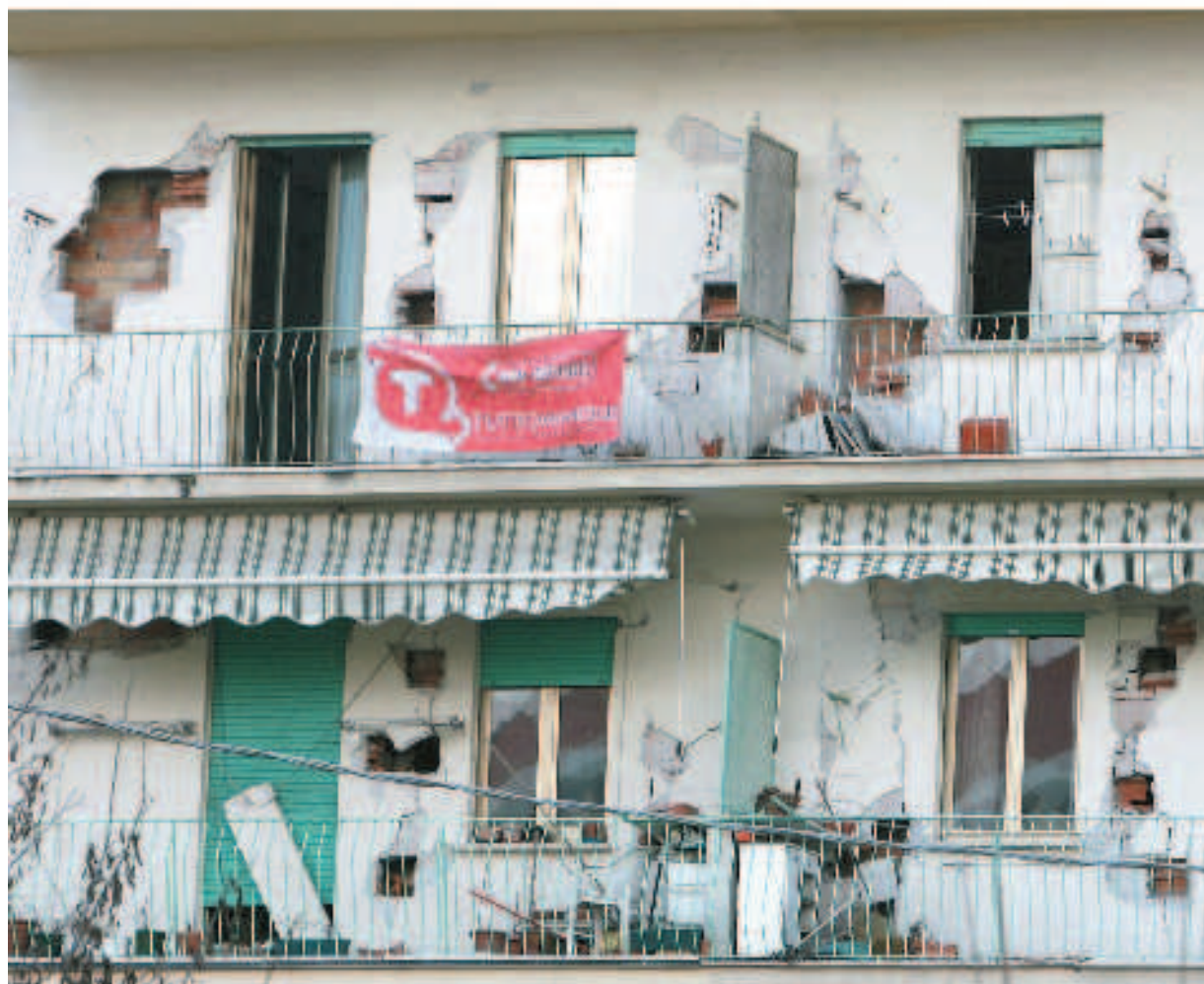
Una palazzina quasi distrutta a L'Aquila dopo il terremoto del 6 aprile 2009
