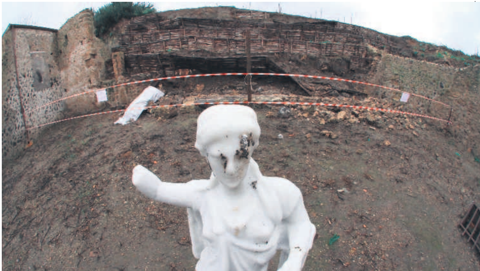
Pompei Il muro di contenimento nella Domus del Moralista crollato lo scorso 30 novembre
