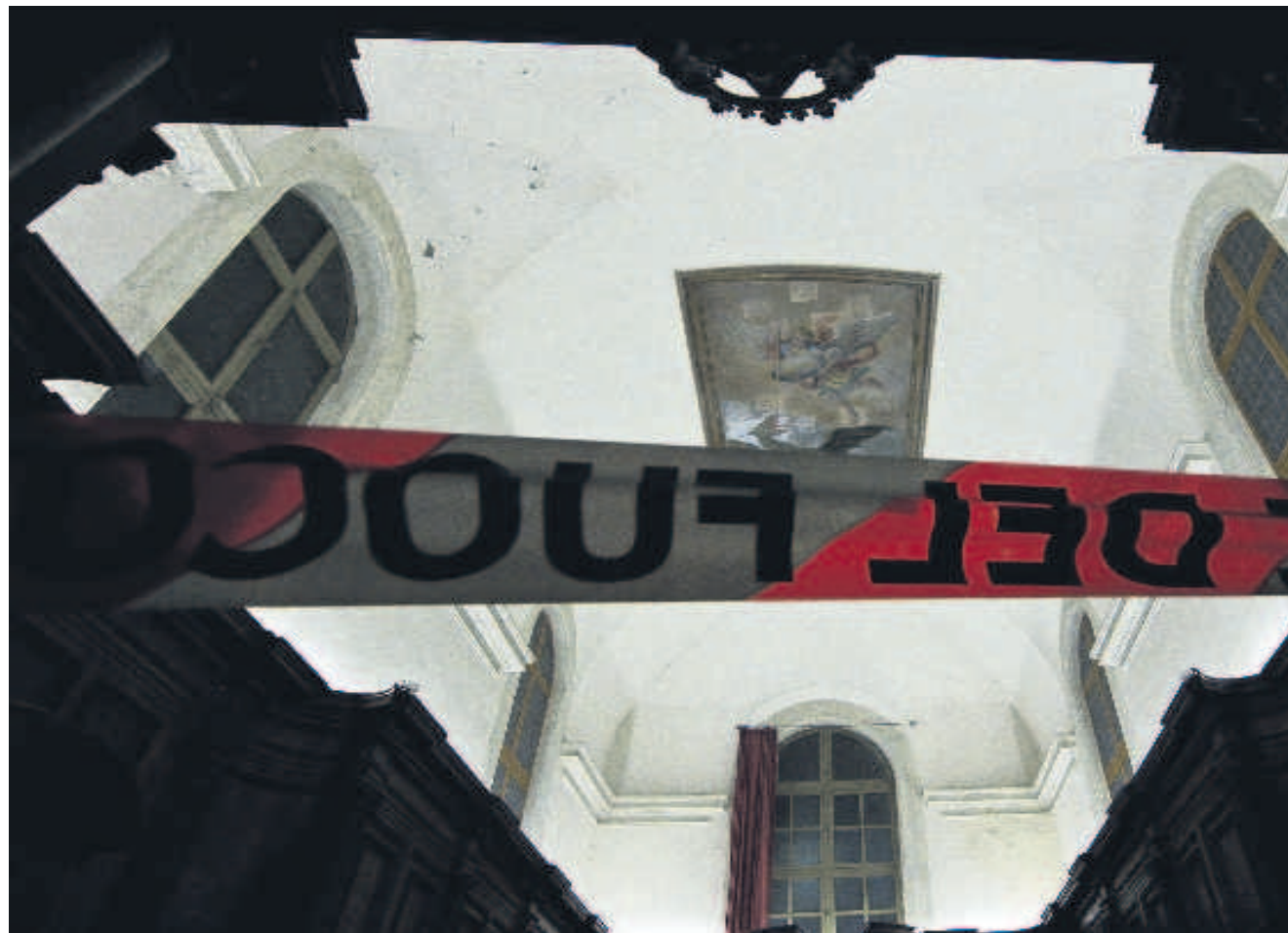
Rischio crollo La chiesa di San Francesco a Ripa Grande a Roma, che ospita la Beata Ludovica del Bernini, chiusa dai pompieri
