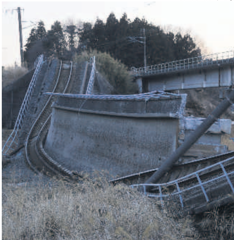
Giappone Un tratto di ferrovia collassato dopo il terremoto
