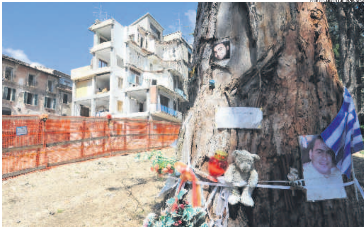
Un edificio di piazzale Paoli a L'Aquila ancora sotto sequestro a due anni dal sisma
