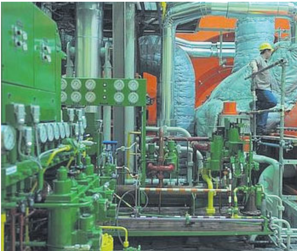
L'interno della centrale belga
