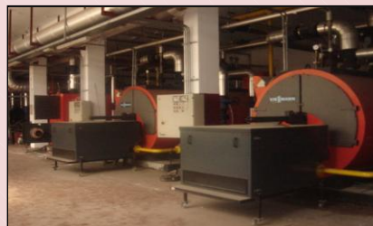
ALDINI II NEL 2011 CON COGENERAZIONE
