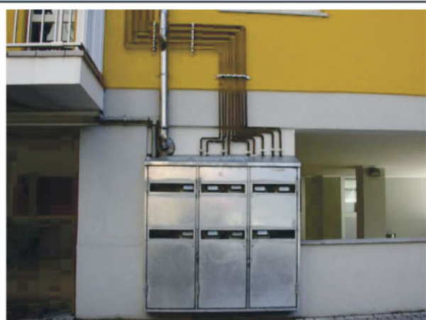
IMPIANTI GAS Progettazione e realizzazione nuovi impianti gas
