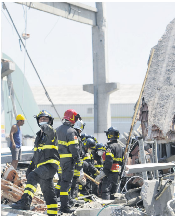
Pompieri al lavoro nella fabbrica crollata a Mirandola
