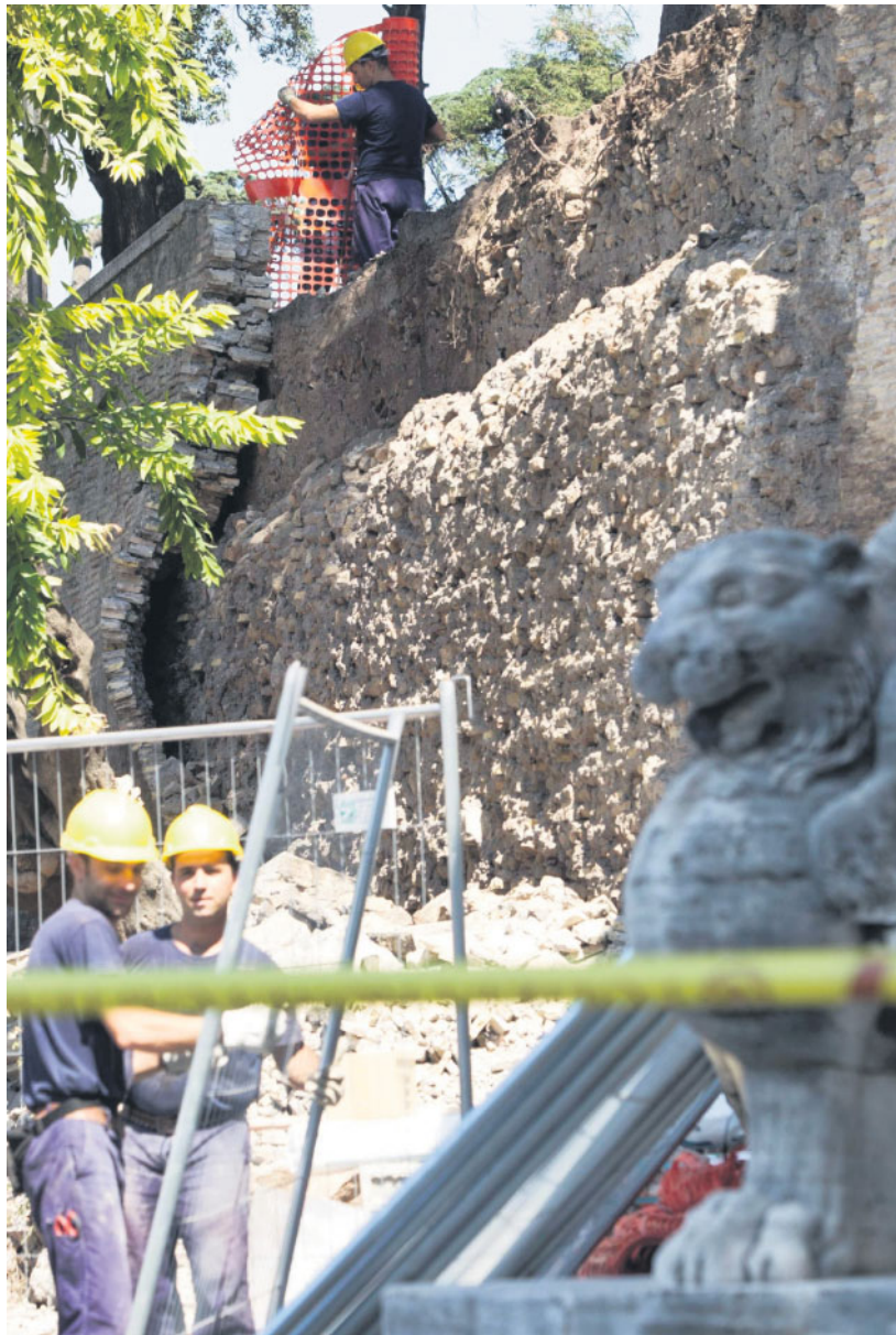
I calcinacci del rivestimento di un muro del Pincio, opera del Valadier FOTO CARCONI/ANSA
