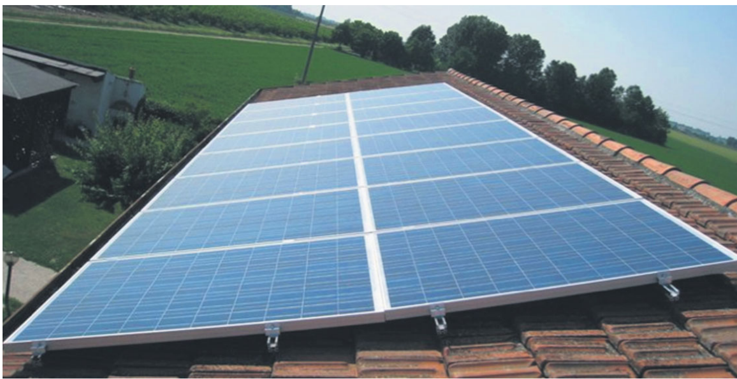
Un impianto fotovoltaico installato sul tetto di una abitazione FOTO ANSA
