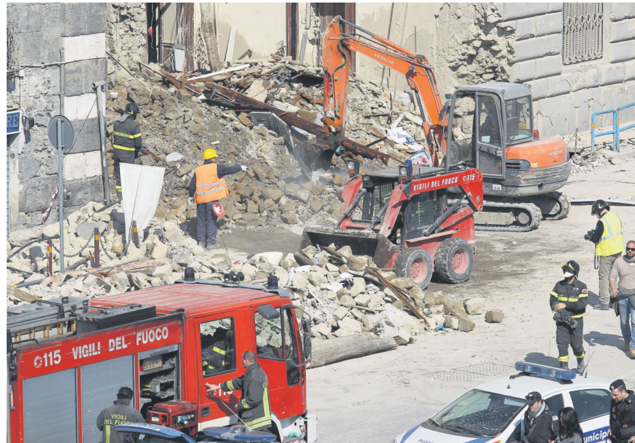
Vigili del fuoco sul posto dopo il crollo FOTO LAPRESSE
