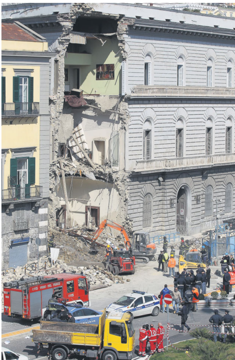
L'ala crollata dell'edificio in via Riviera di Chiaia, a Napoli. FOTO LAPRESSE
