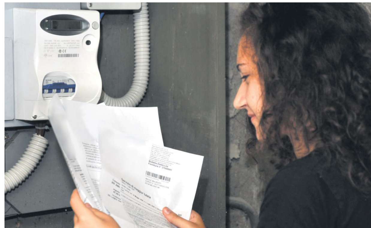
Un contatore elettrico
