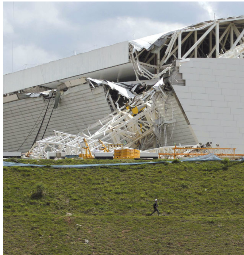
La copertura crollata dello stadio Itaquerao di San Paolo FOTO REUTERS/NACHO DOCE
