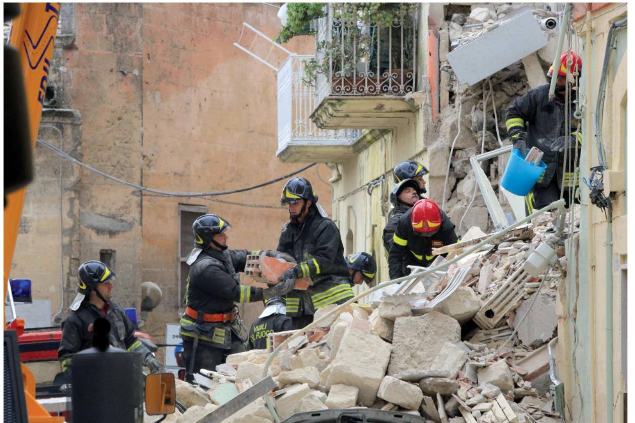
Vigili del fuoco al lavoro tra i resti della palazzina crollata nel centro storico di Matera. FOTO DI EMILIANO ALBENSI/LAPRESSE
