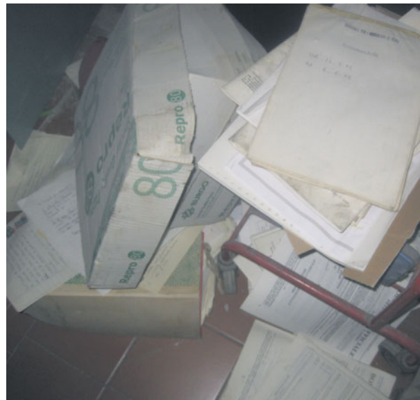
Carte utilizzate per tamponare le infiltrazioni d'acqua
